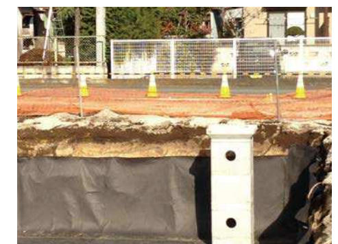
コンクリート製点検管理樹
