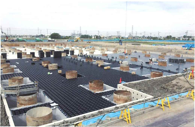
流通会社倉庫（地下ピットに設置）
