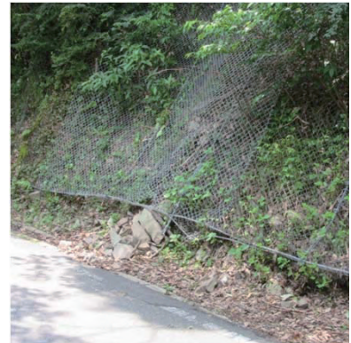
落石防護網裾のこぼれ出し状況
