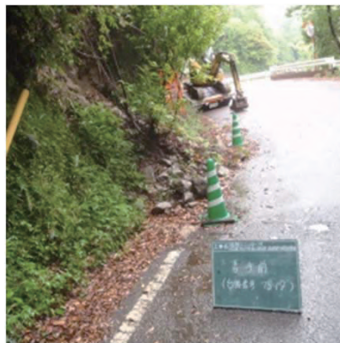
小規模崩壊の状況
