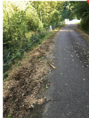
【グレーチングより山側※1】 道路わきに痕跡あり
