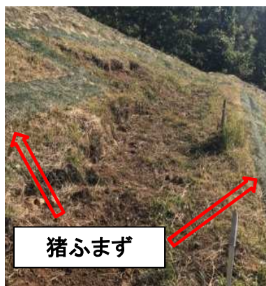
排水路が閉塞した小段
