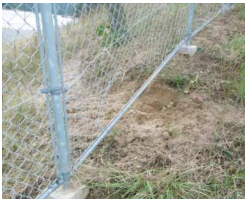
イノシシによる破壊・侵入口
