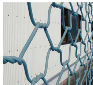
30年経過のフェンス
