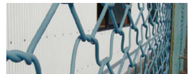
約30年経過したSTKネットフェンス (製造当初は青色で製造)
