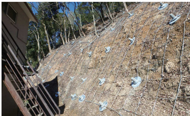
平成 27 年 5 月 急斜面土砂崩壊防止施設整備工事（金閣寺地区）
