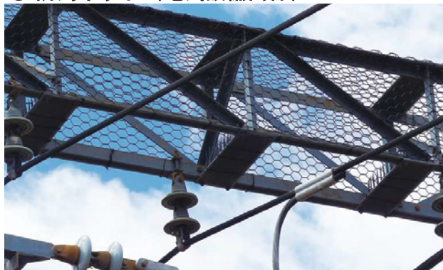
平成 27 年 9 月 JR 広島操車場防鳥ネット
