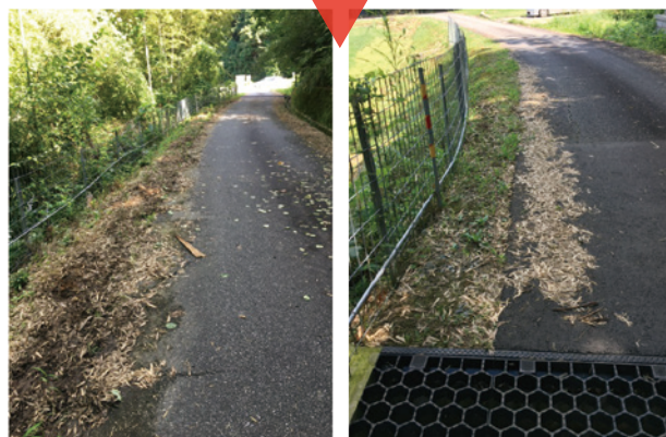
【グレーチングより山側※1】 道路わきに痕跡あり
